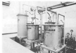
灯油槽 / 可燃性廃液受槽 / 難燃性廃液受槽
