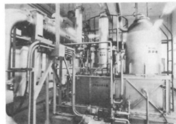
デミスター / 冷却器 / 洗浄塔 / 冷却洗浄受水槽 / 冷却塔
